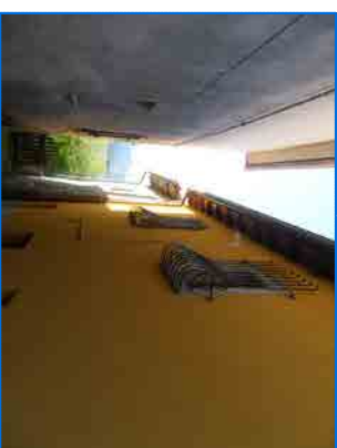
Foto 6 - Danno e Degrado
