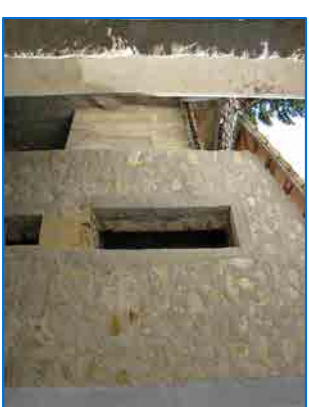
Foto 6 - Danno e degrado
