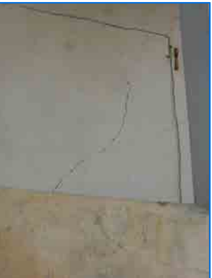
Foto 7 - Danno e Degrado
