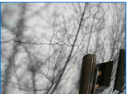
Foto 2 - Danno e Degrado
