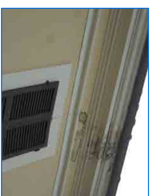
Foto 7 - Danno e Degrado
