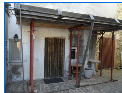
Foto 4 - Danno e Degrado
